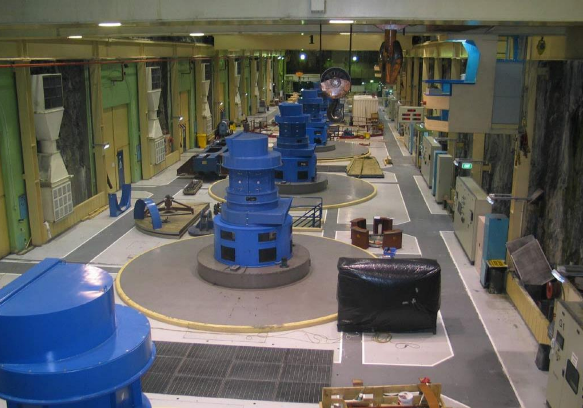
Vízierőmű, turbinacsarnok, Manapouri, (Új-Zéland)
